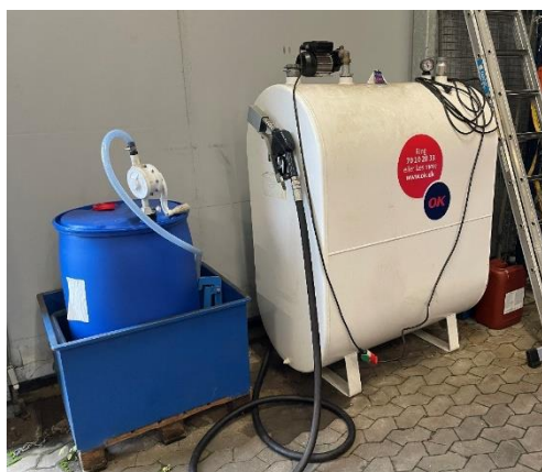
Tank placeret i udendørs hal, spild efter brug af pistol
