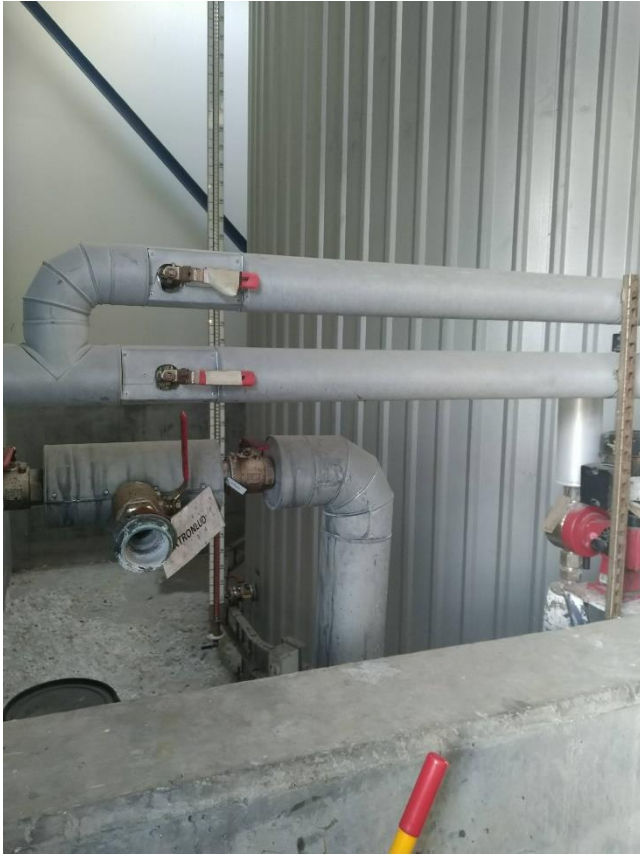
Tank og studs til påfyldning af natronlud
