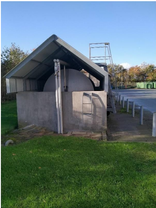
Overdækket olietank – påfyldning sker gennem luge i taget
