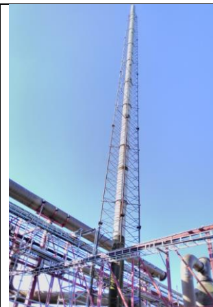
Figur 7. Nødafkast til luft fra A-bunker m.m.
