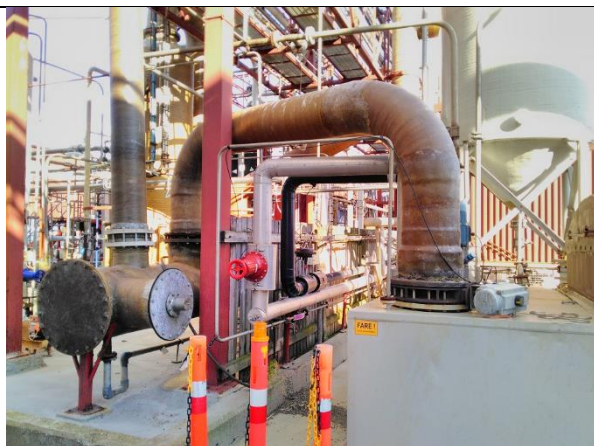
Figur 3. Afsug og basisk skrubber ved dampplads.
