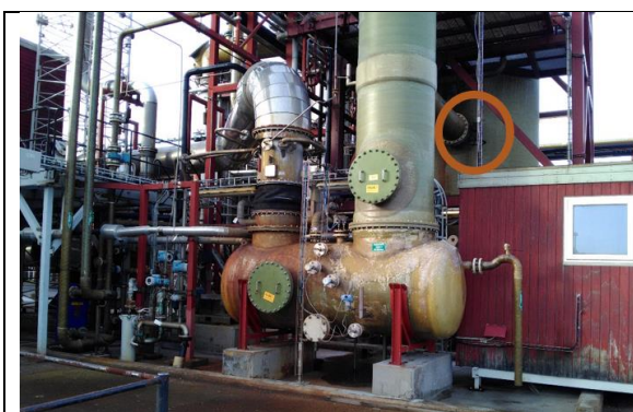
Figur 14. Sulfitskrubber på Clausanlæg. Afledningen til CLF-skrubber er markeret med orange ring.
