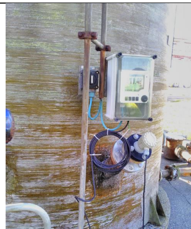
Figur 6. pH-måler på skrubber ved A-bunker.
