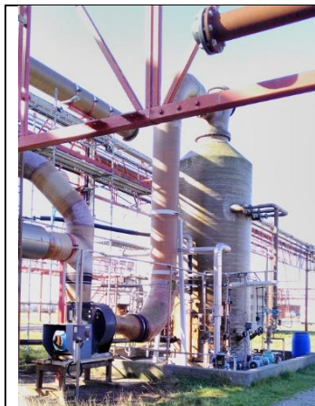
Figur 5. Basisk skrubber ved A-bunker.
