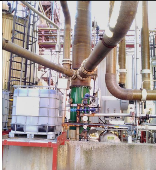
Figur 1. Sur skrubber ved DMT- og forsøgsanlæg.
