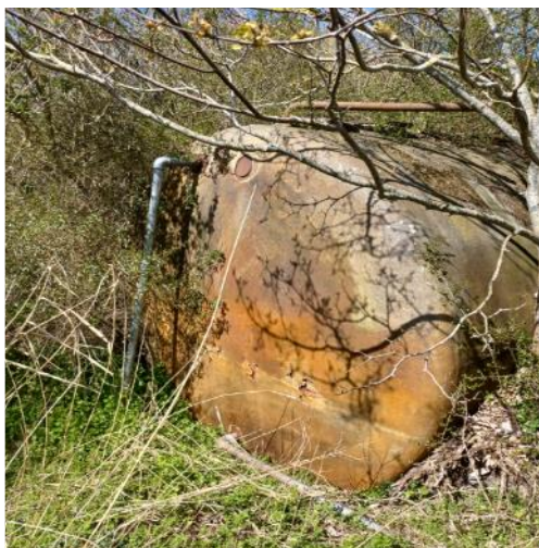
Tank 1 hele bagsiden. Rørforbindelse til tank 2 og tilløbs/tilbageløbsrør t fra/til perkolatpumpebrønden
