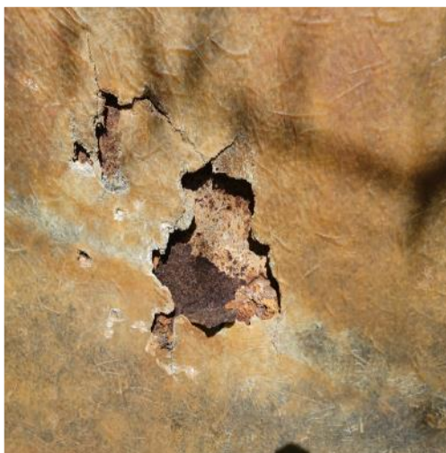
Tank 1 bagside. Glasfiber kappe brudt og flager af rust på endepladen
