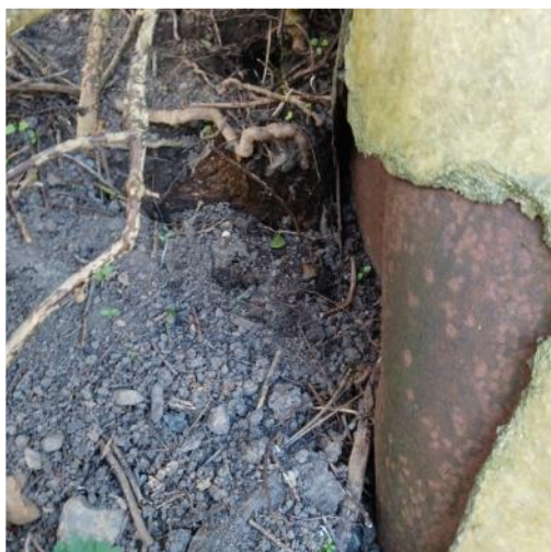
Tank 1 forsiden i jordniveau. Glasfibernappen er brudt.
