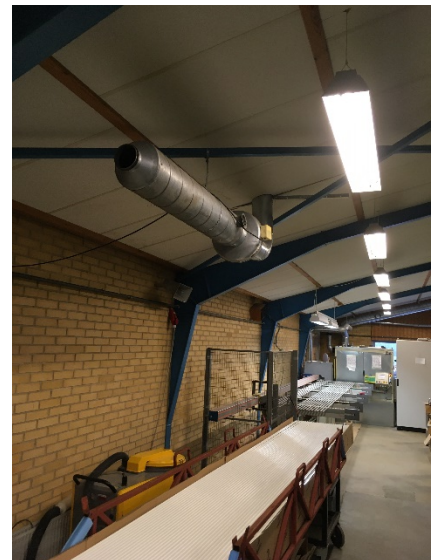
Udsugningsrør ved udsugningsanlæg 1 – Anvendes ikke.
