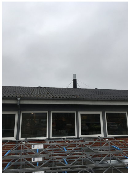
Forlænget afkast ved udsugningsanlæg 4.
