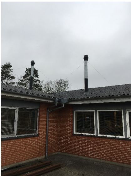
Forlængede afkast ved udsugningsanlæg 2 og 3.
