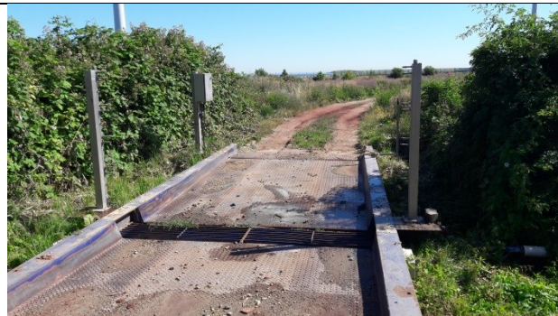
5. Automatisk vaskeplads ved indkørslen fra den NV-SØ gående vej for lastbiler.
