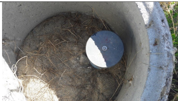
12. B1 med aflukket rør (DGU nr. 201.7449)
