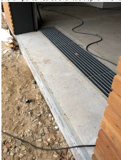
Eksempel på sump nedfældet ved porte
