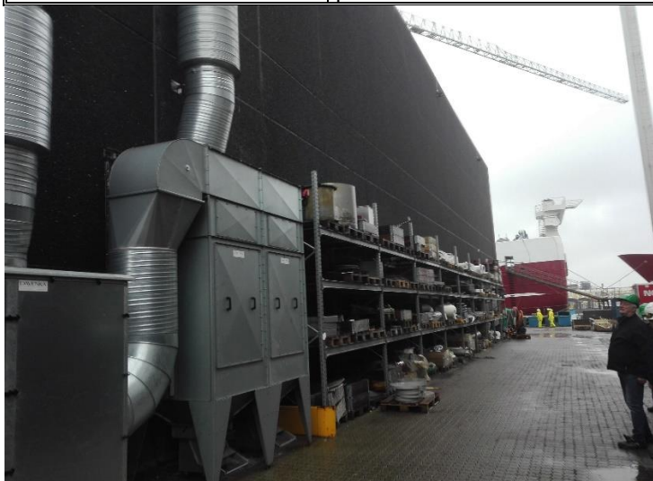
Nyt filteranlæg på nordøstsiden af hal 9.
