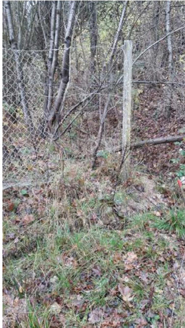
Figur 1: Hul i hegnet i det nordøstlige hjørne ved etape 2 og 8
