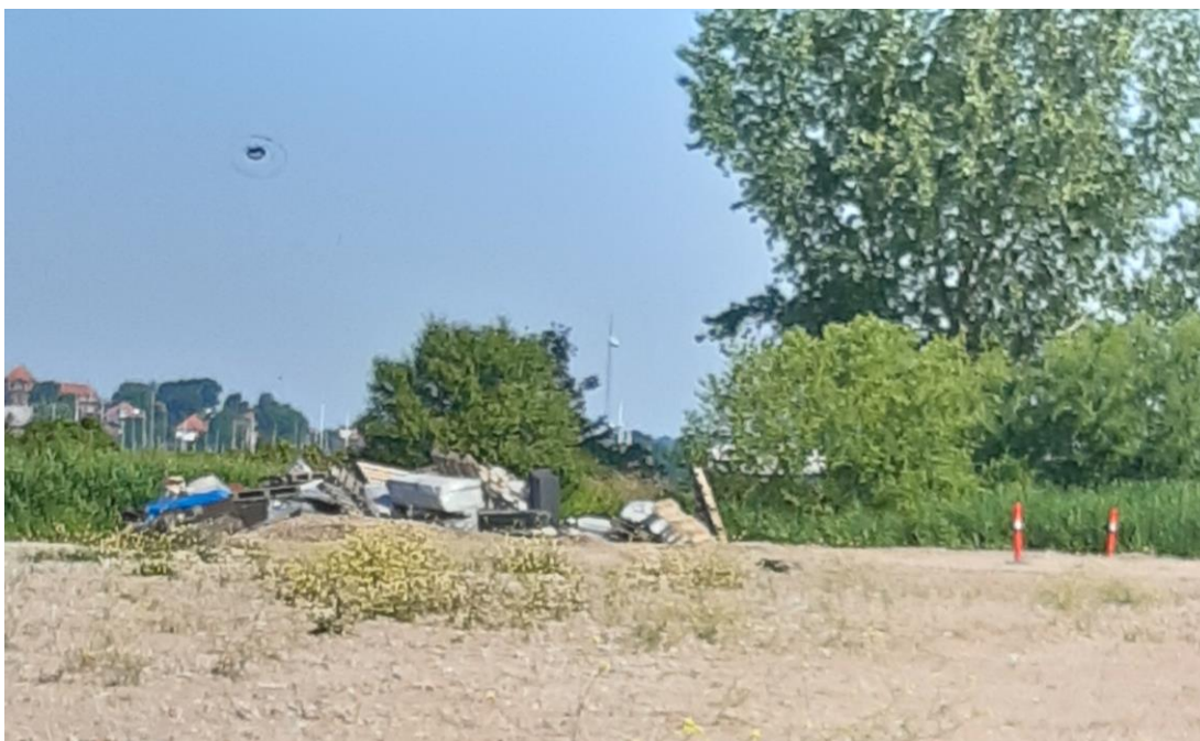
Figur 5 Asbest tippet af lastbilerne, hvor der ikke er sket straksafdækning.
