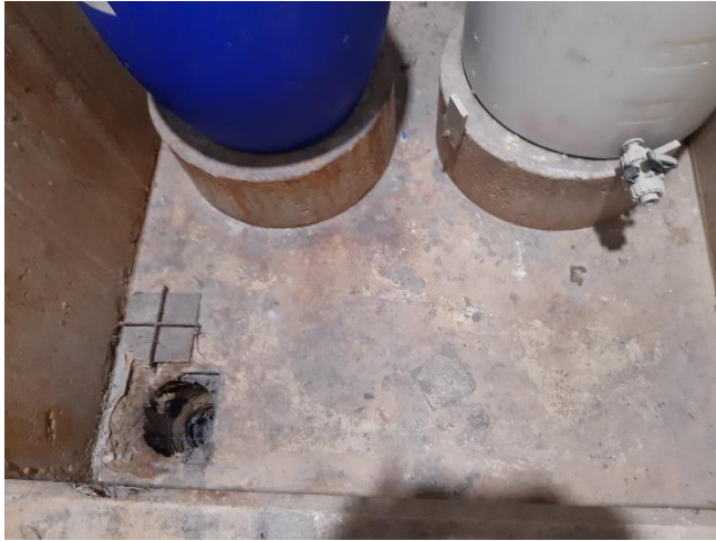
Foto 1: Afløb i oplagsplads til kemikalier. Afløbet fører til spildevandstank.
