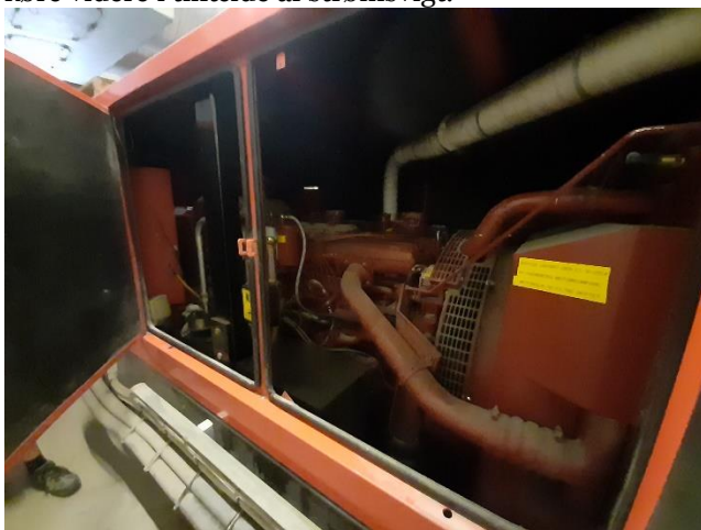
Foto 6: Dieseldrevet nødstrømsanlæg med egen olietank.
