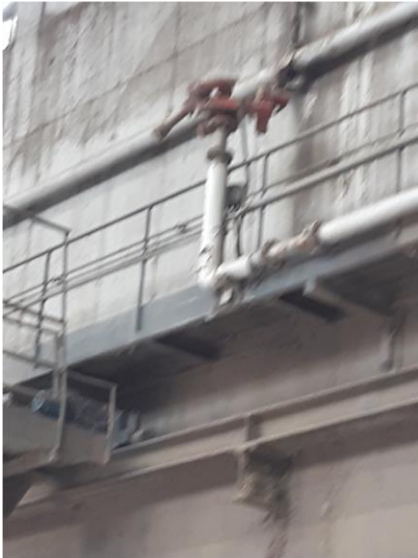
Foto 7. Brandslukningskanon i affaldssiloen. Kanonen er fjernstyret og kan skyde rent vand eller brandslukningsskum
