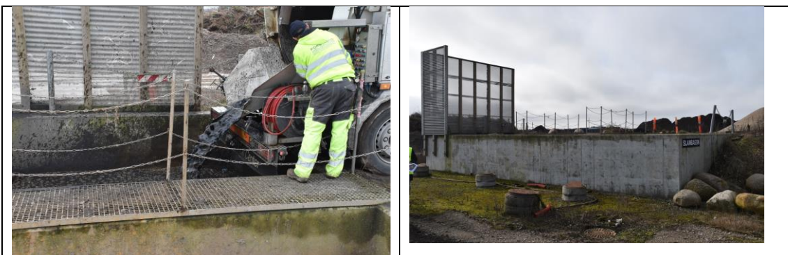
Aflæsning af slam fra vejbrønde til slambassinerne. De nye slambassiner ønskes placeret vinkelret på de eksisterende.
