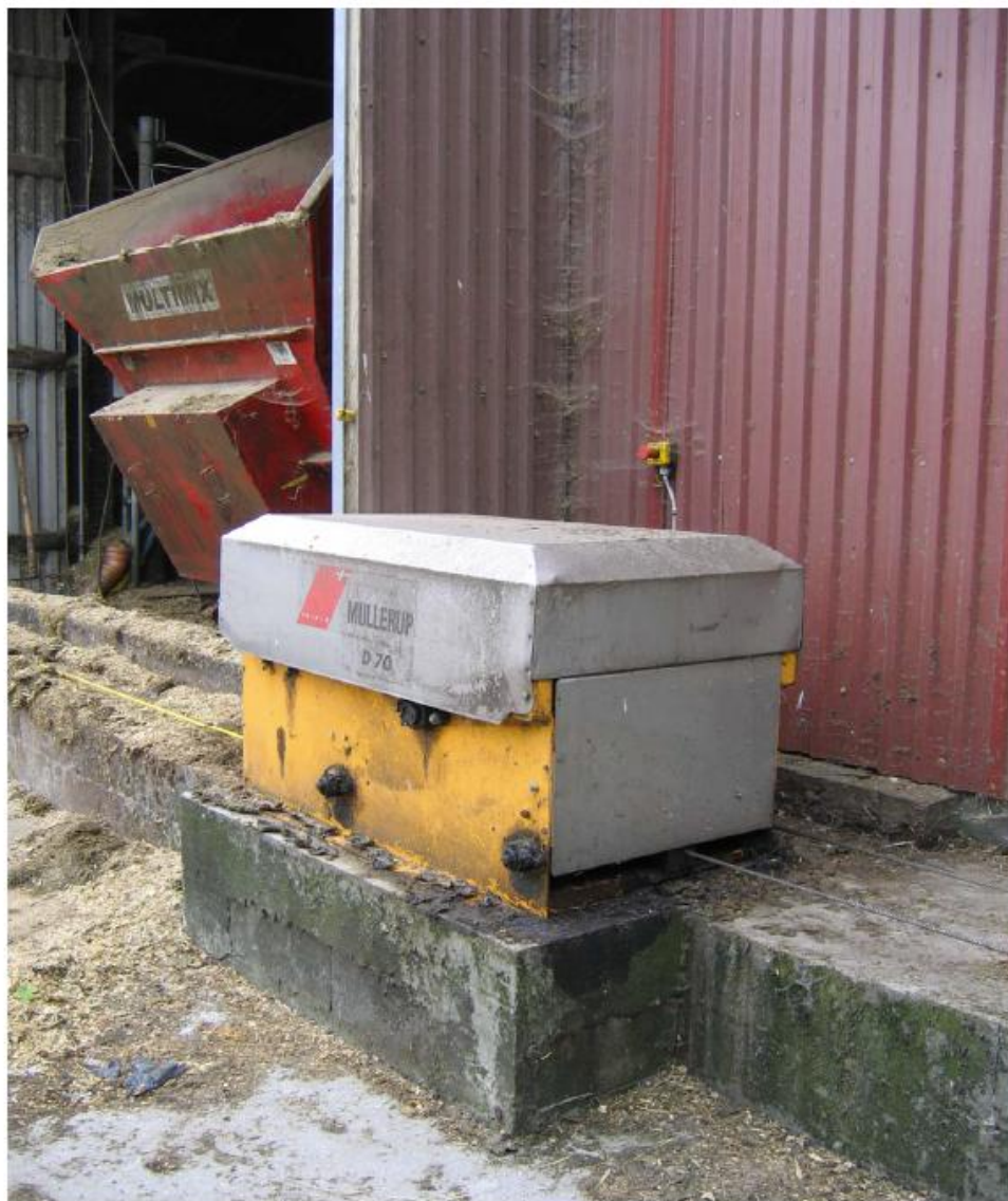
Billede 1. Trækstation med wiretræk placeret udendørs.
