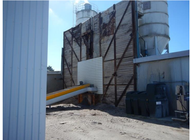
14. Beton-blandeanlæg inkl. Cementsiloer. Lukket transportbånd fra silo + doseringsanlæg til blandeanlæg.
