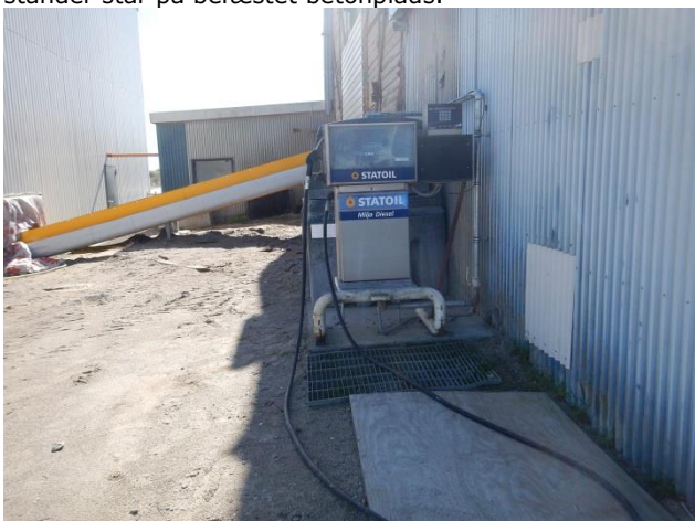
11. Foran: Stander til Dieseltankanlæg + påfyldnings-slange. Det er efter det oplyste kun gummihjulslæsser der benytter dette. Beton-lastvogne tanker andre steder.
