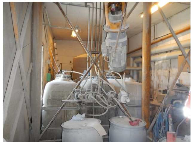
16. Tilsætningsstoffer til beton oplagres i 3 plasttanke + enkelte plasttromler.
