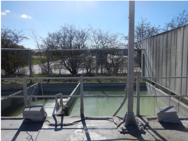
1 . Sandfang ved vaskeplads for beton-lastvogne
