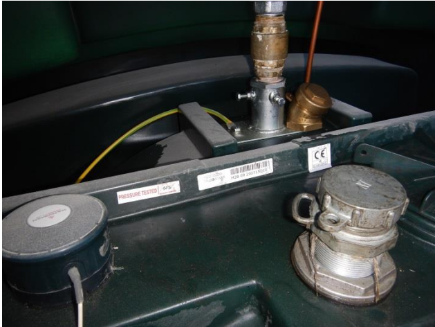
13. CE mærket tankanlæg. Påfyldningsstuds bag aflåselig låge.
