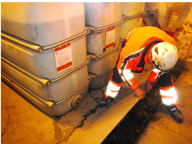
17. 3 De 3 plasttanke til tilsætningsstoffer. Spild løber via betongulv videre til afløbskanal dækket af stålplader, til 5000 l spildevands-opsamlingsstank.
