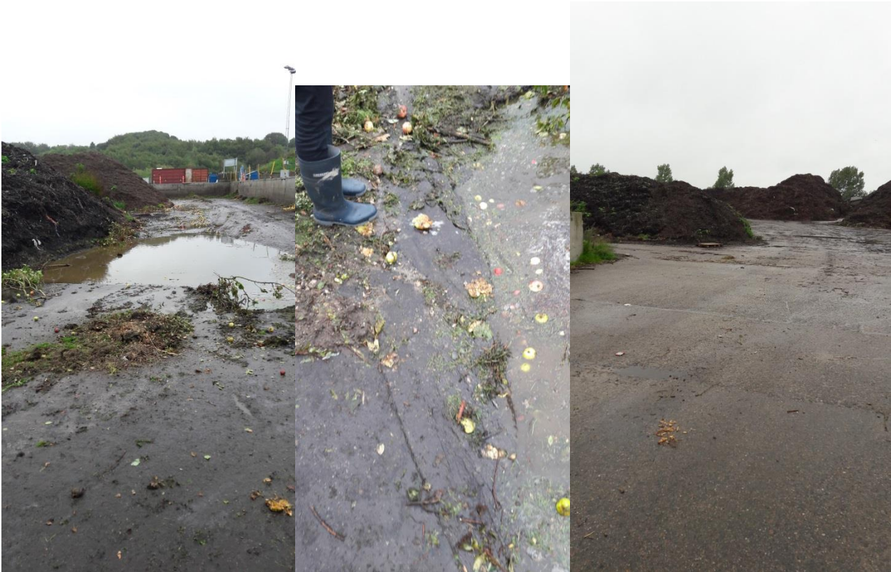
Figur 15 Beskadiget belægning og lunger i komposteringspladsens belægning.
