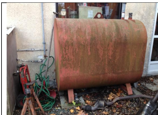
Foto 1 fyringsolietank på ubefæstet areal
