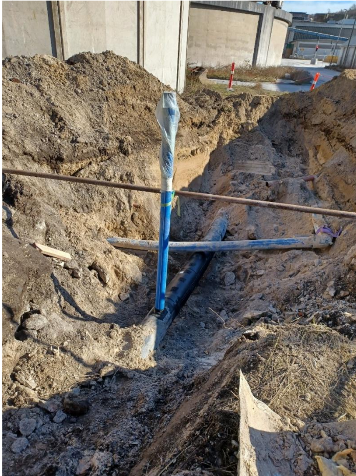
Filtratvandslækagen blev besigtiget. Lodret "sladrerør" ses i midten.
