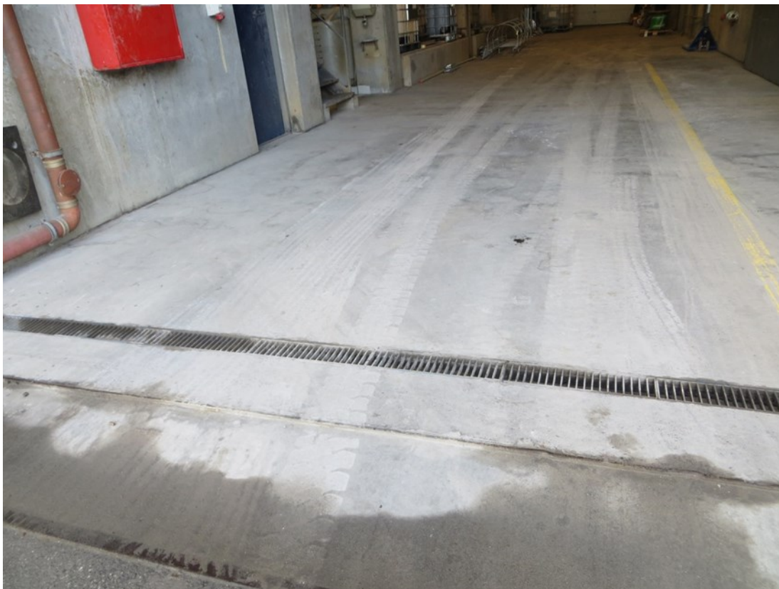
Spild på gulv under flyveaskeudtag. Billede taget ved tilsynet 8. december 2016
