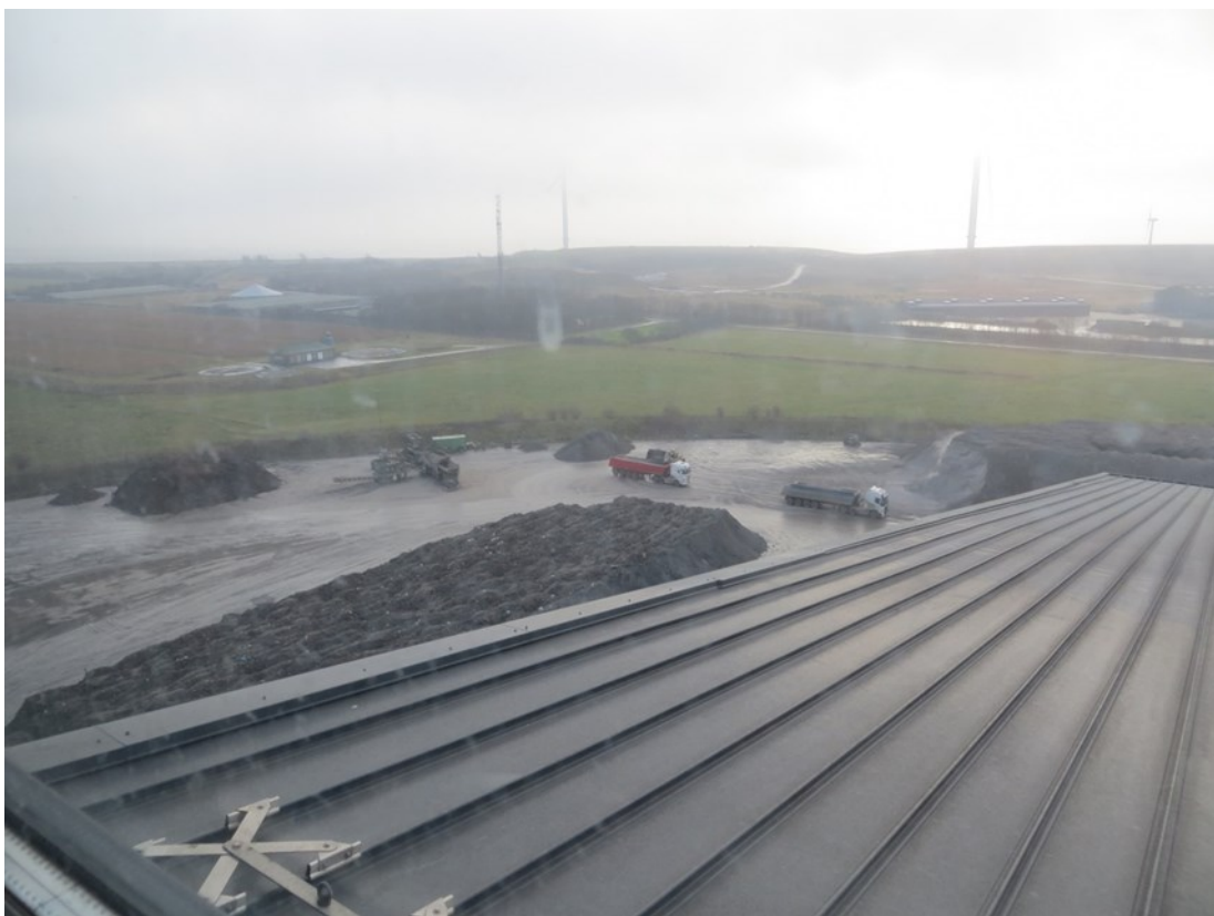
Slaggepladsen afvandes til underjordisk tank. Billede taget ved tilsyn 8. december 2016.
