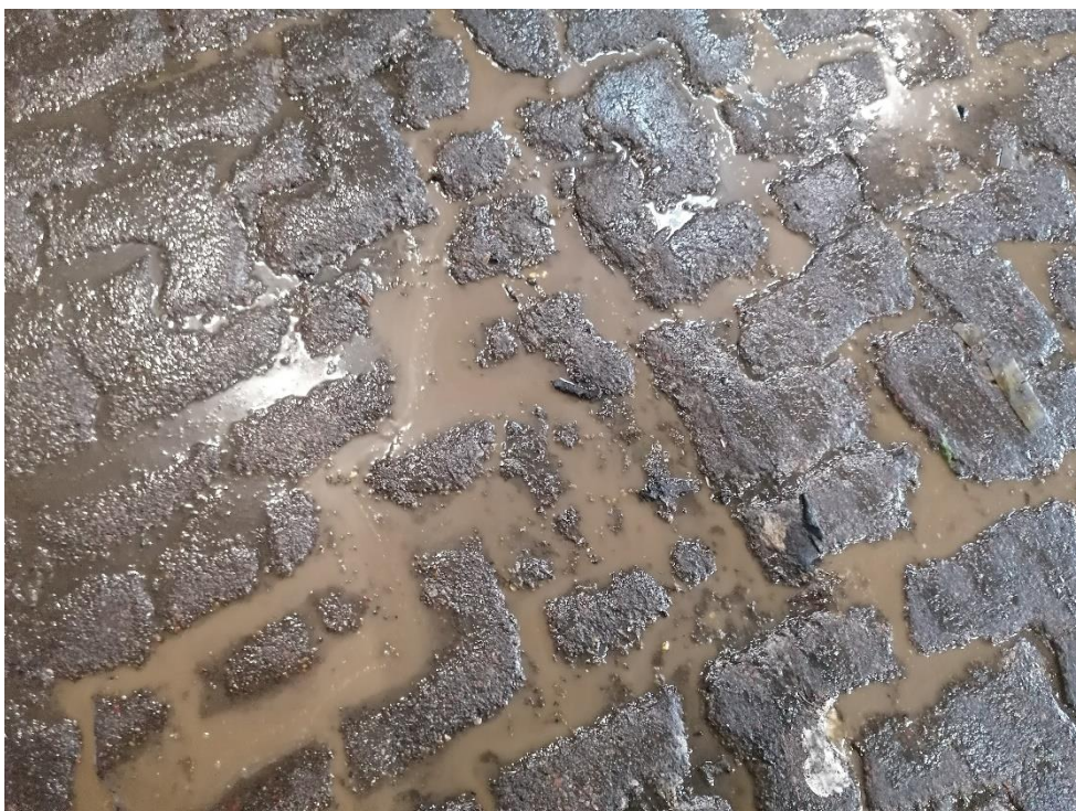
Belægningen uden for båsen er beskadiget og nedslidt. Vaskevand og perkolat tilbageholdes
