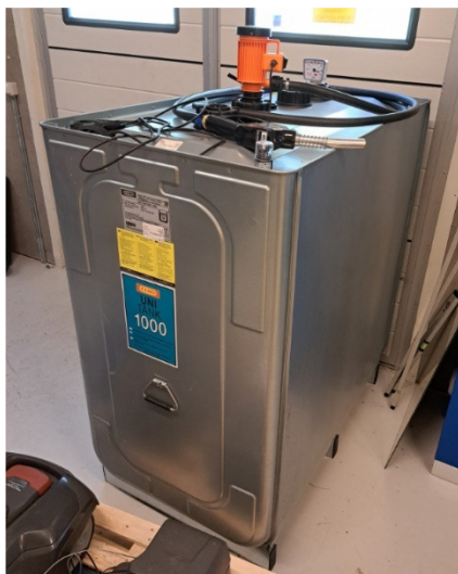
Billede nr. 1: 1000 liters dobbeltvægget olietank til nødstrømsanlæg.
