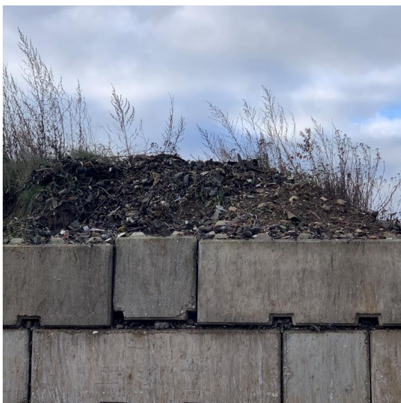
Affald der er kommet ud over afskærmningen og ligger på ubefæstet areal til venstre for RAF 2 hal.
