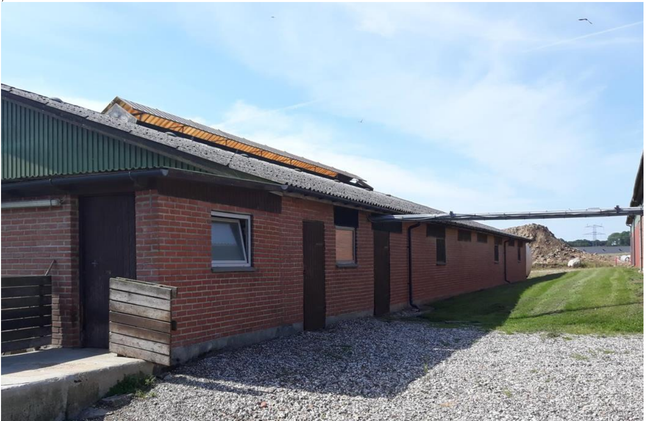
Foto: Staldbygningen har naturlig ventilation. Tag-kip og vinduesåbninger indstilles manuelt for at styre luft og temperatur.
