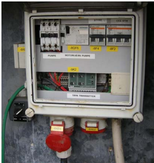
Figur 4.14 Lokaltavle på centerpumpebrønd CP3.
