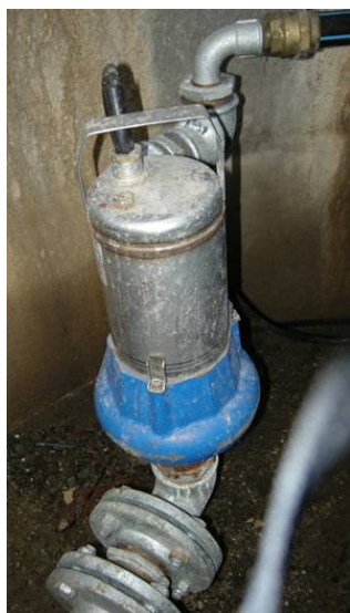
Figur 3.24 Rørtømmepumpe TP 01 i ventilbygværk.
