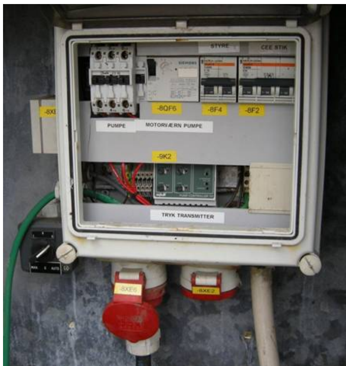
Figur 3.16 Lokal styretavle for pumpe CP3
