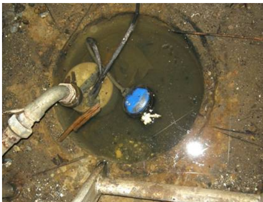
Figur 4.22 Sump i ventilbrønd med kælderpumpe
