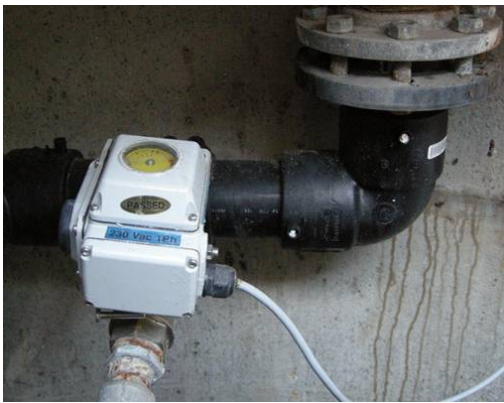
Figur 4.19 Motorventil MV01 på rør for slangetømning via TP 01.
