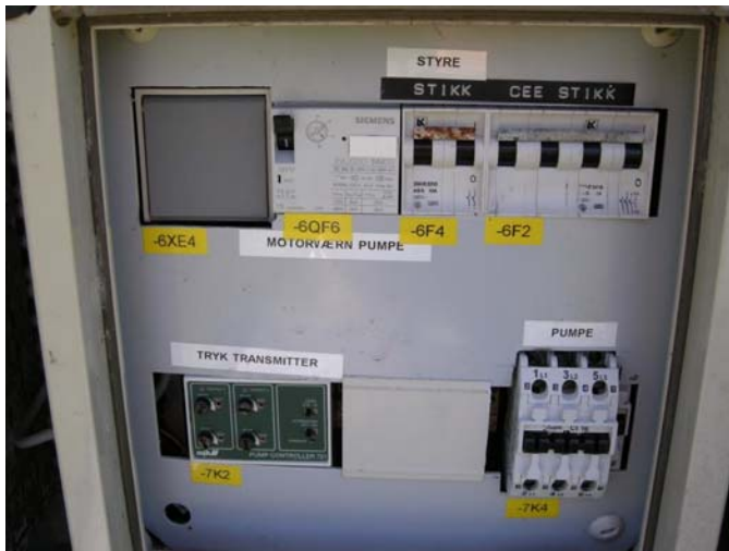
Figur 4.11 Lokaltavle på centerpumpebrønd CP2.
