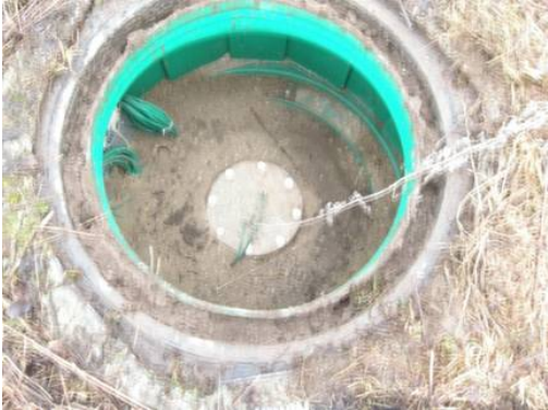
Figur 4.22 Nedføring af kabler til niveaumålere på nordligt dæksel på buffertanken.
