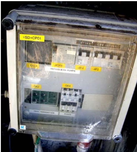
Figur 4.7 Lokaltavle på centerpumpebrønd CP1.
