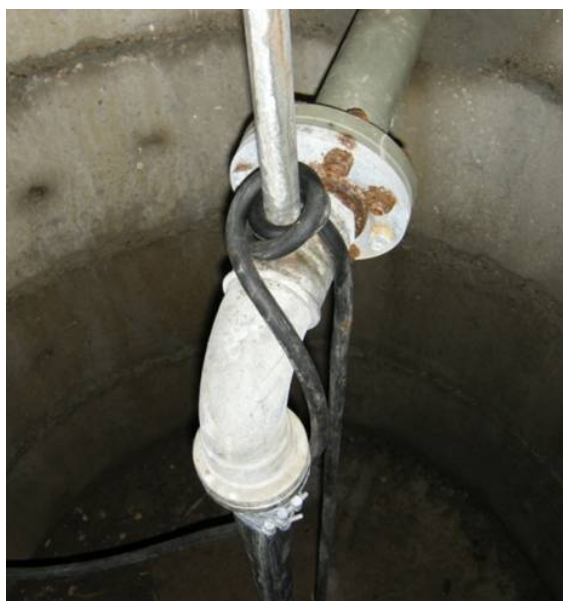
Figur 3.9 Tilslutning af tryksslange fra pumpe CP2 til jordledning.
