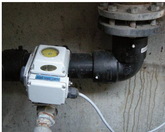
Figur 3.26 Motorventil MV01 på rør for slangetømning via TP 01.
