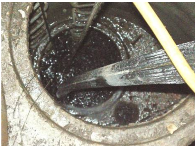
Figur 3.4 Utæt tryksslange fra pumpe CP1 - under pumpning
