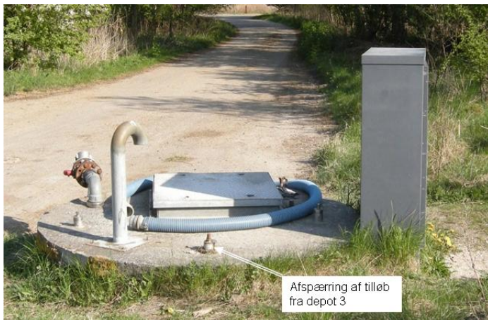
Figur 3.20 Ventilbygværk med kobling for oppumpning på tankbil.
