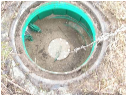
Figur 3.19 Nedføring af kabler til niveaumålere på nordlige dæksel på buffertank.
