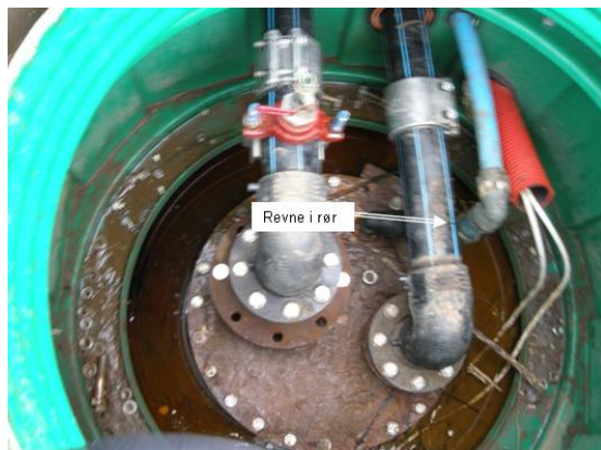
Figur 3.18 Rørdedføringer på sydlige dæksel på buffertank.
