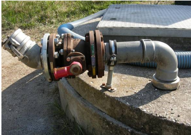
Figur 3.23 Modtagestuds for tankbil på ventilbygværk.
