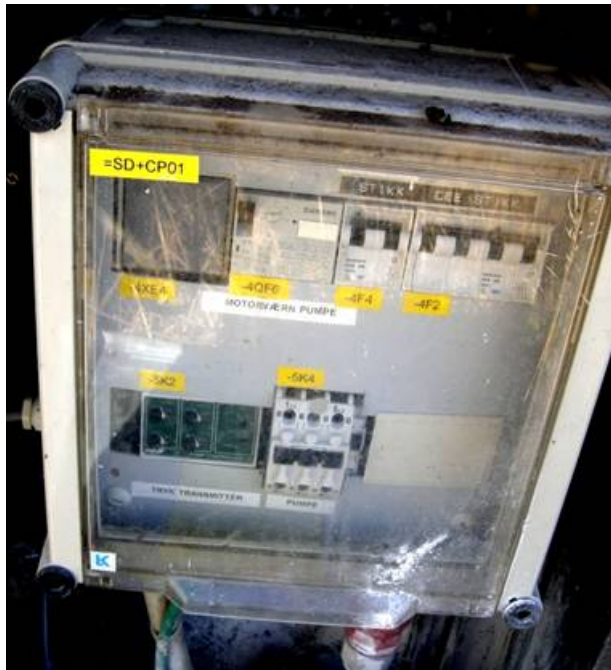
Figur 3.5 Lokal styretavle for pumpe CP1
