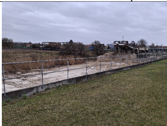
Kig ned i sand/grus bassin
