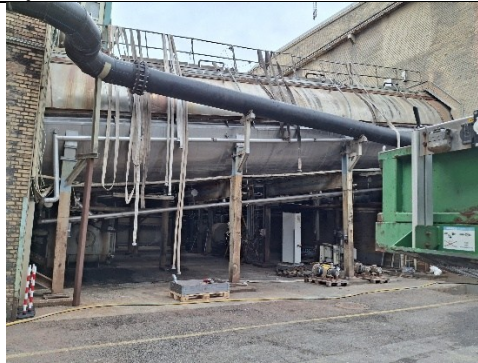
Tromlevasker der bliver vedligeholdt
