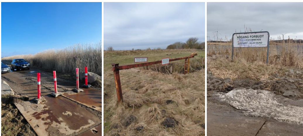
Foto 6. Til venstre: Indkørselsvej mod vest mangler aflåselig bom. Midt i: Skilte ved nordlig indgang til deponiet. Til højre: Skilt ved Vandfelt Vest med grafitti.
