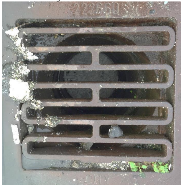
Figur 2 Regnvandsbrønd i Snedkervej. Bunden af brønden er fyldt med flamingo og der ligger noget ovenpå risten.
