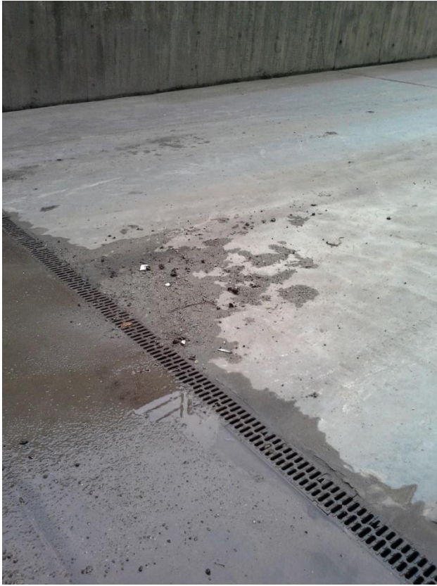
Synligt spild af slagge udendørs ved udkørsel fra slaggekælder
