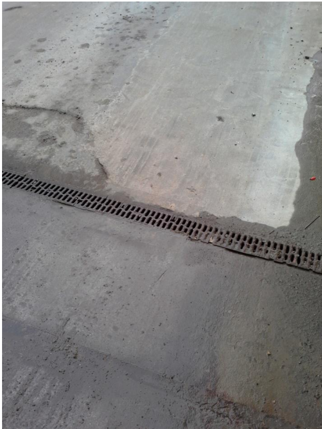
Revner i betonbelægning ved afløb nær udkørsel fra slaggekælder
