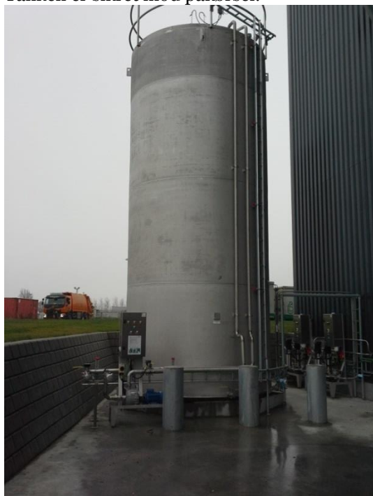
Ny tank til ammoniakvand sikret mod påkørsel. Instruktion synlig ved betjeningspanel.
