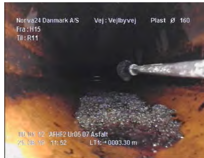
FOTO 006 00:00:58 3.3 m AFHF 2 Asfalt
