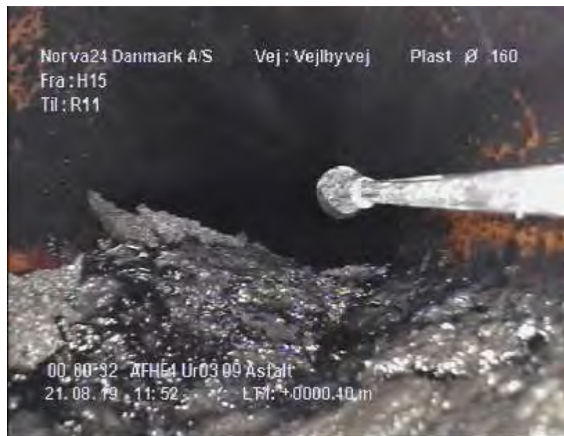
FOTO 005 00:00:21 0.4 m AFHF 4 Asfalt
