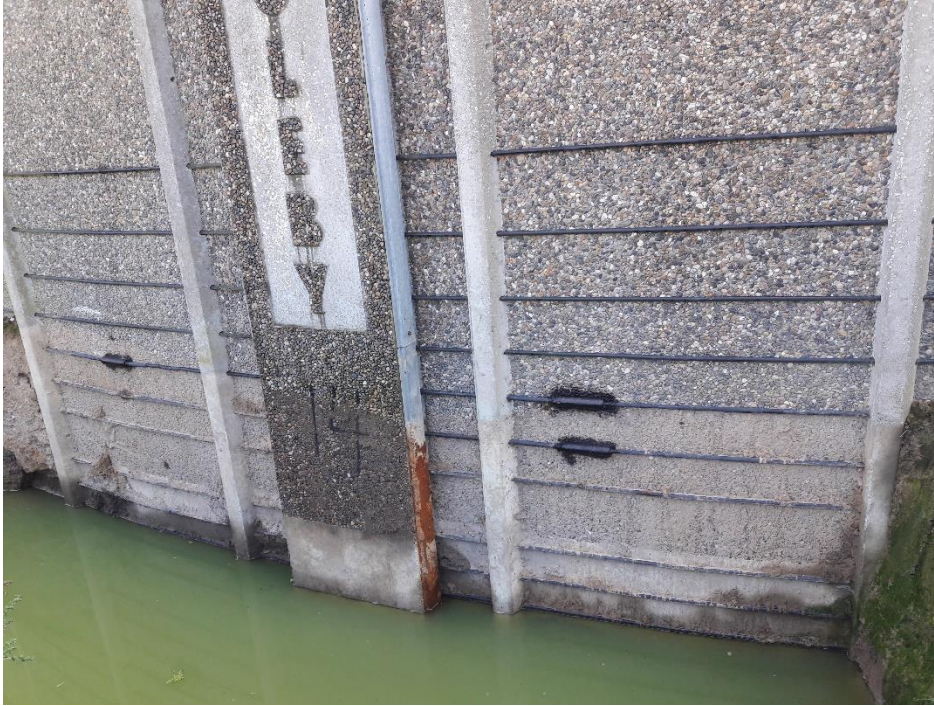
Kabler med reparationer
