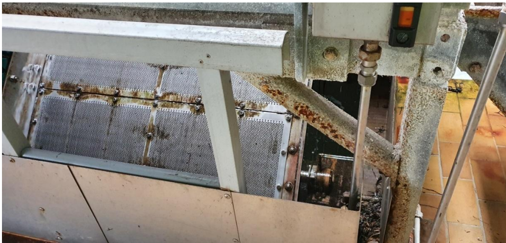
Figur 2-3. Billede af havvandsfilter i Renseværkbygningen.
