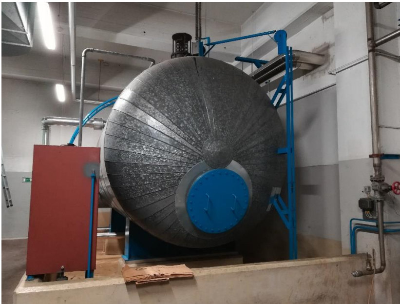
30 m 3 Dagtank til Fuelolie leverer til blok 5 og blok 6
