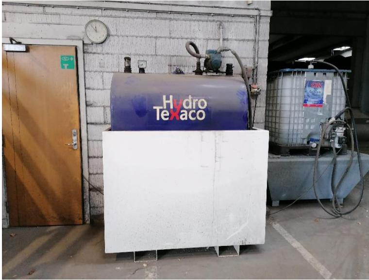
Olietank til tankning af køretøjer placeret i lagerbygningen for kul, flyveaske og bundaske.
