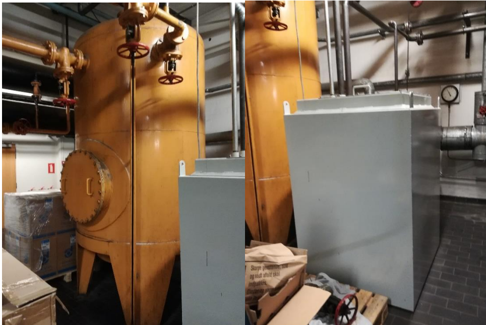
Smøreolietank og slamtank.
