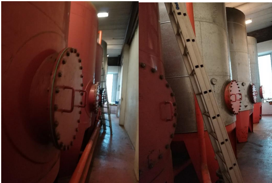
6 dagtanke til dieselbygningen. Står på 2. sal. Rummet fungerer som spildopsamling kan indeholde en mængde svarende til ca. 2 tanke.
