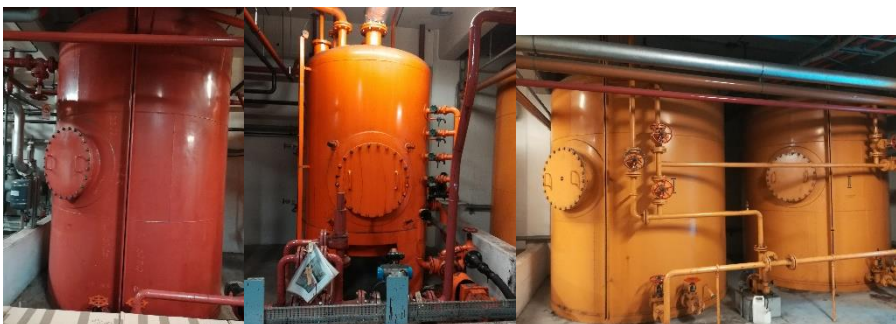
Rød tank anvendes som tømmetank. Der står ikke olie i tanken ud over dette. Orange tank er til olieslam. Gule tanke er til smøreolier. Alle står i grundplan i dieselbygning.
