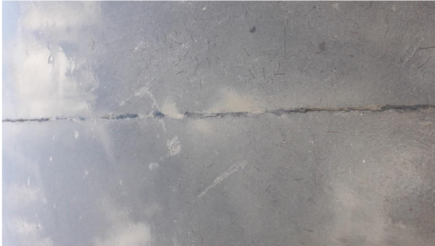
Foto 1. Slidte fuger på vaskeplads.
