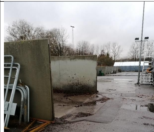
Foto 11. Vand fra vejskrabspladsen holdes væk fra den øvrige plads med en lille kant, så det løber til olieudskilleren.
