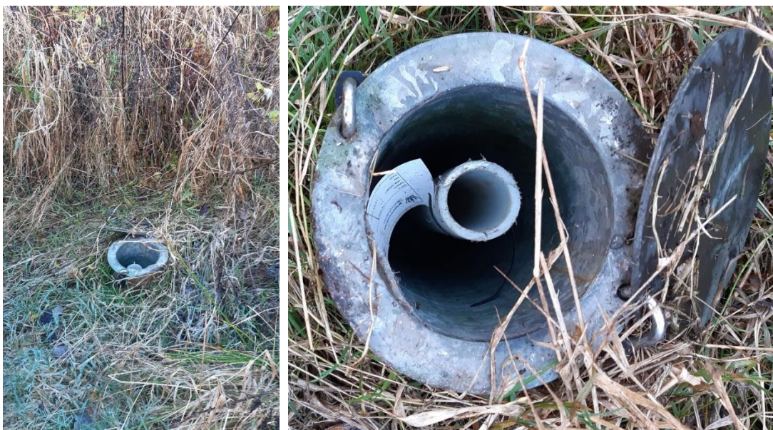
Figur 17. Boringen med DGU nr. 76.1607. Til venstre: boringen er placeret lavt i terrænet. Til højre: Boringen mangler vandtæt forerørsforsegling.
