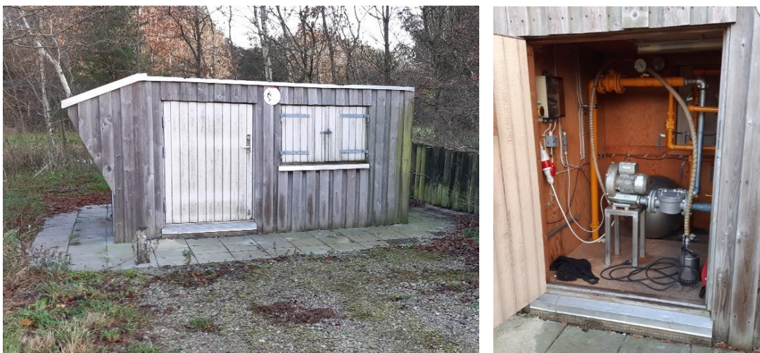
Figur 12. Gasafværg: Afværgeanlæg. Tv: bygning set udefra. Th: pumpe og andre installationer.
