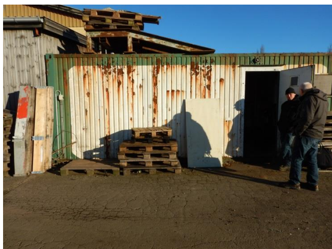
7. Lukket container til tank, der anvendes til oplag af motorbenzin, tappet fra miljøbehandling af biler
