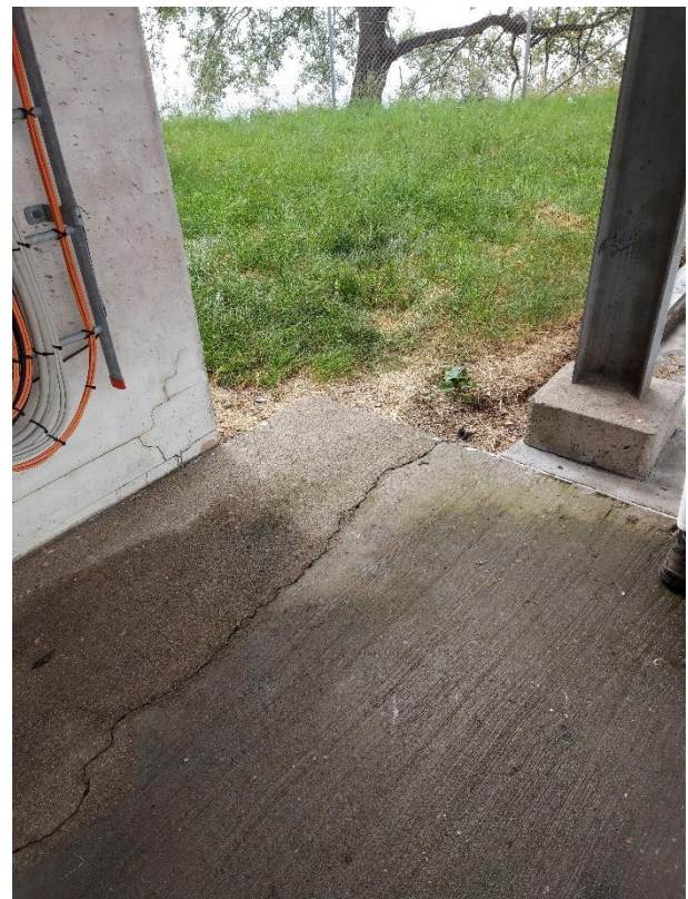
Figur 4 Manglende opkant ved ny Tank 80
