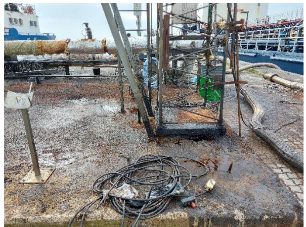
Figur 2 Spild på pier
