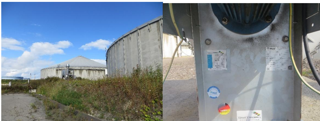
Kulfiltre og blæser på 4 tanke, tank 31.10-31.13, og specifikationer på blæser.
