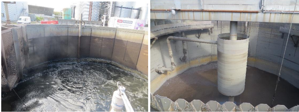
Slamtank 61.02 og slamtank 61.01
