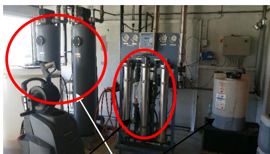
Billede nr. 3: Demineraliseringsanlæg, Omvendt osmoseanlæg, Tanniner Det samlede blødgøringsanlæg (2022)
