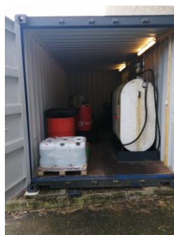
Billede nr. 7: Dieseltank i container (2019)
