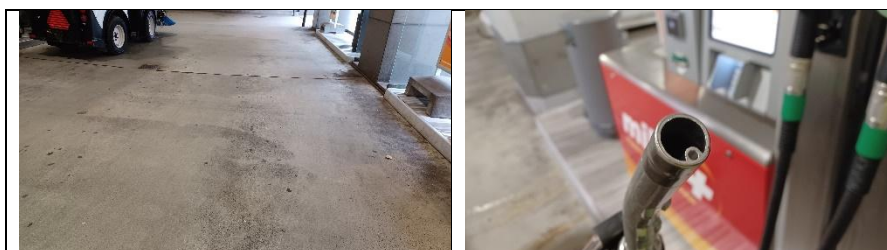
Belægning og påfyldningspistol med returløb for luft.
