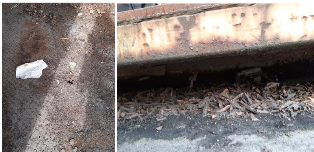
Figur 6 Container til farligt affald med dobbeltbund, hvor den øverste bund er rusten og har gennemtæring (billedet tv). Den nederste bund bar også præg af rust og mulig gennemtæring, der er bunden, der er bunden, der kan skimtes, en 3 cm tyk rille, ses der, hvor der hænger et blad ned fra (th).
