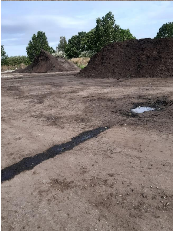
Figur 9 Defekt belægning på pladsen til kompostering.
