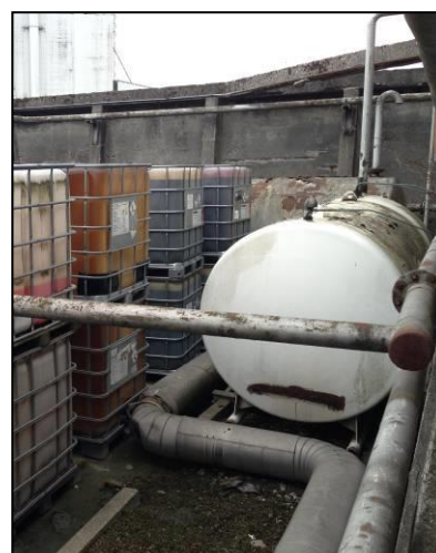
Tank 4: Herover foto af tank ved råvareområdet – nu tømt og ude af drift
