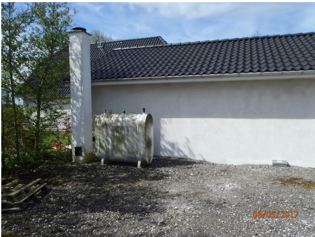
Billede af stuehusets fyringsolietank på 1200 liter
