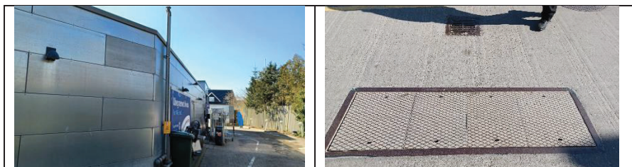
Påfyldningsstudse under dæksler og udluftning fra tanke.
