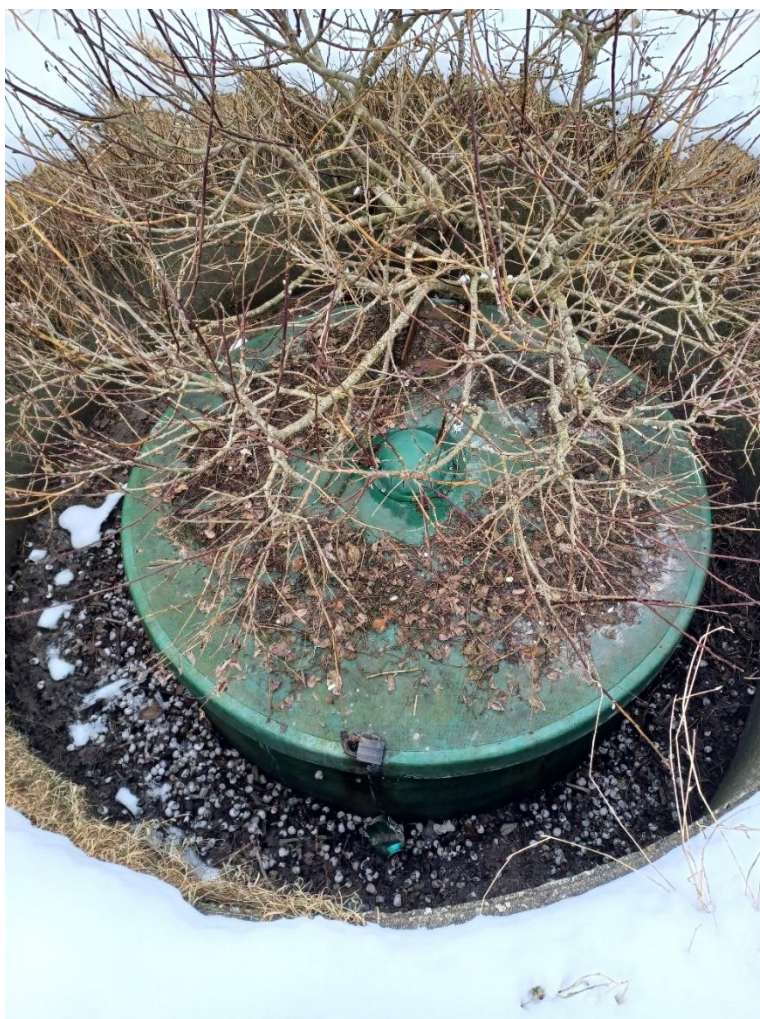
Foto 3. Perkolatbrønd for det samlede deponi (etaper 1-4).
