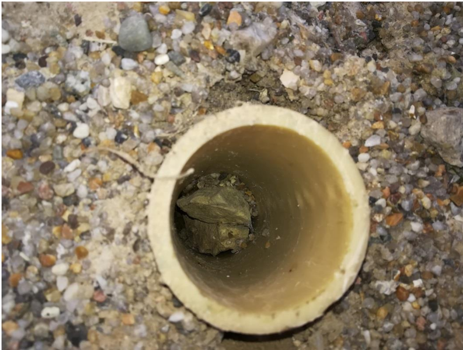
Figur 9. Monitoringsbrønd. Tilstoppet af mindre sten.
