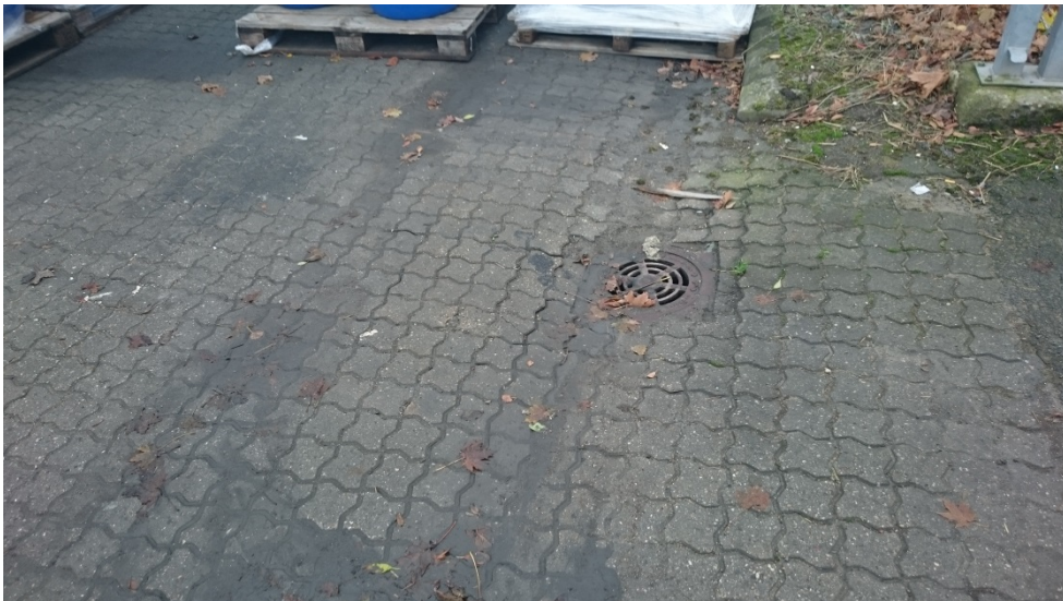
Belægning på gamle lagerplads. Utætheder omkring afløb
