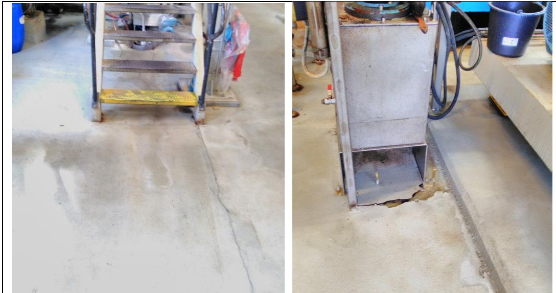
Belægningen på produktionsanlægget havde revner og overfladebelægning fæstner ikke tilstrækkeligt. De samme problemer gik igen for belægningen på formuleringsanlægget.
