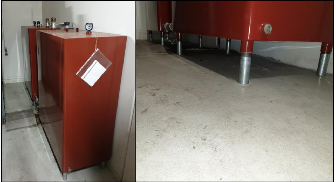
Figur 2.6: Olietanke til anlæg "Aage" placeret Hjelpebygningen. Foto: NIRAS 11. maj 2021.
