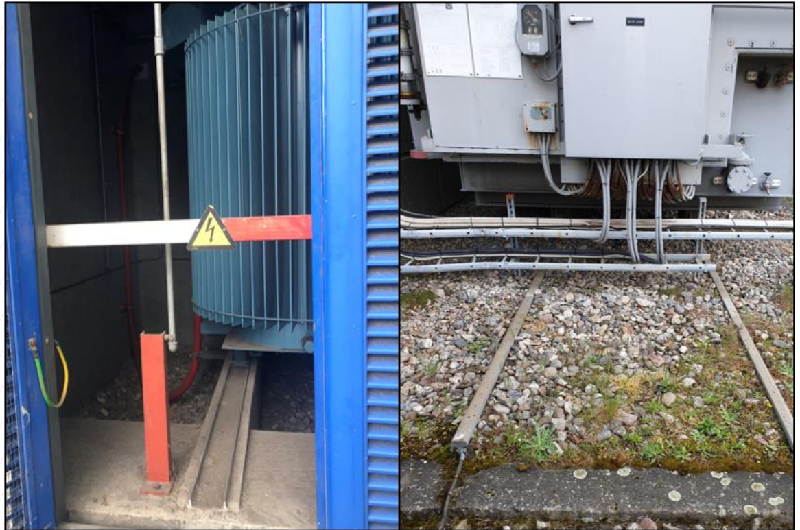
Figur 2.3: Transformere placeret på sump/grube til opsamling af olie. Venstre: indendørs transformere; højre: udendørs transformere. Foto: NIRAS 11. maj 2021.
