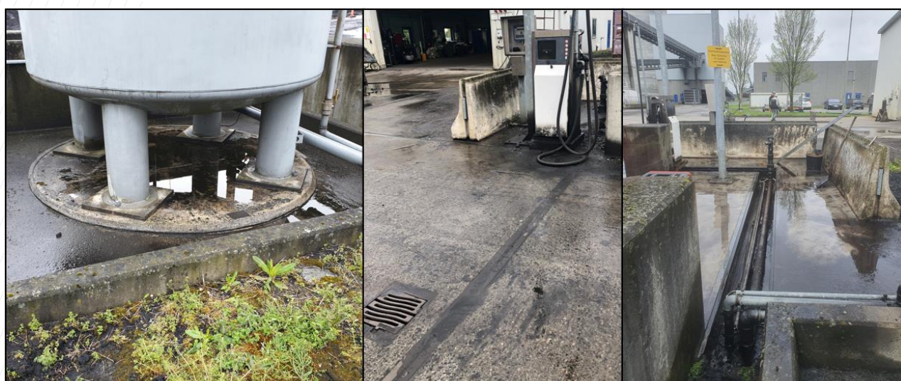
Figur 3.6: Fotos af dieselanlæg. Venstre: Dieseltank på ben placeret i tankgrav; midt: påfyldningsstander på befæstet areal med afløb; højre: forbindelsesrør i grav, påfyldningsstuds er placeret i "knækket", hvor rørføringen drejer mod venstre. Foto: NIRAS og FFP 11. maj 2021.
