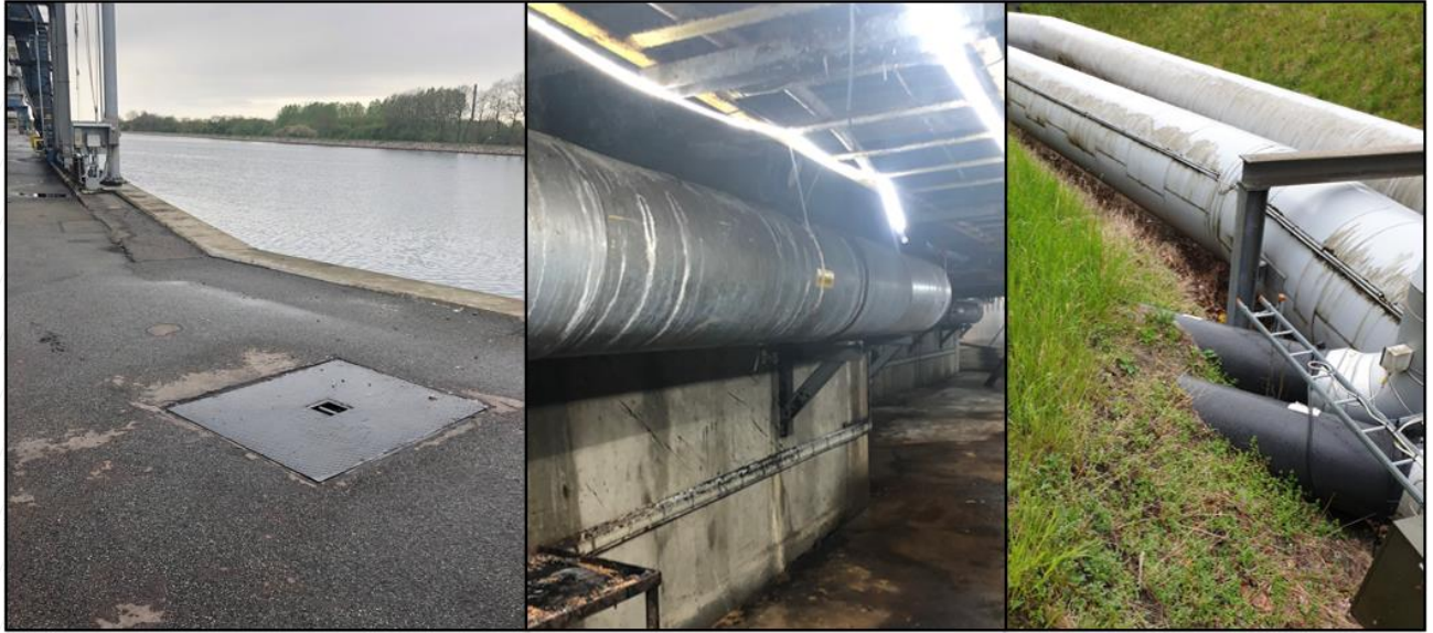
Figur 3.2: Fueloliesystem. Venstre: Loadingsystem ved havnen (under dæksel i molen); midt: rørføring i kælder fra havn til HFO tank 11; højre: start på nedgravede rør mellem tank og Blok 7. Foto: NIRAS 11. maj 2021.
