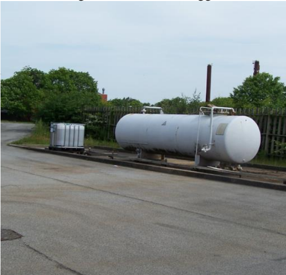
Syre beholder og lufttank.
