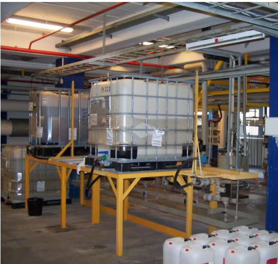
Syrer og baser, der benyttes i anodiseringsanlægget. Spild løber til opsamlingsbeholder.
