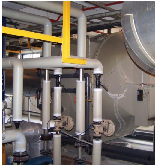
Del af scrubber – rør til anodiseringsanlæg.
