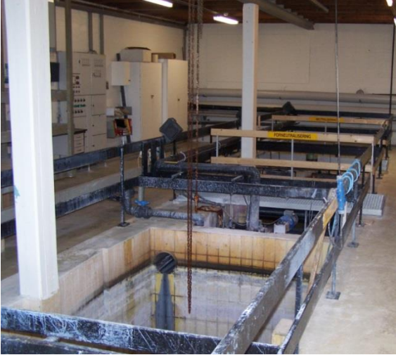
Neutraliseringskar i forrenseanlægget.
