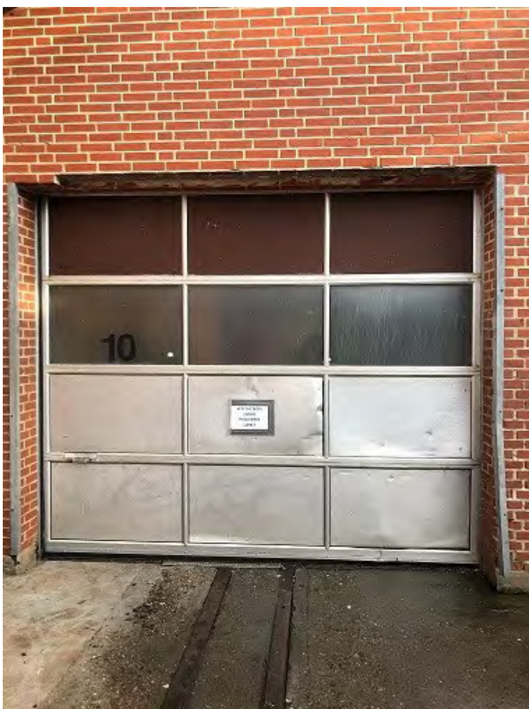
Lokale 10. Port til affaldsrum. Der er automatisk lukke på porten. Porten står åben i forbindelse med afhentning af affaldsfraktioner. Porten skal holdes lukket.
